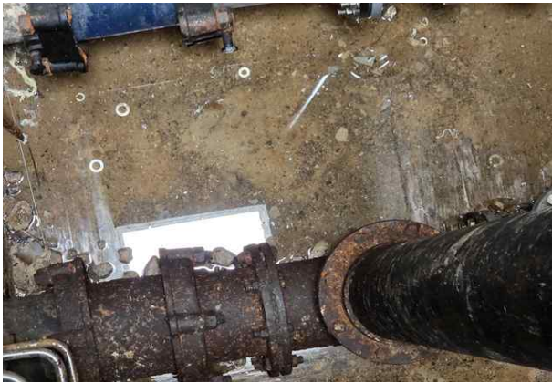
손상내용 유출밸브실(1지) 바닥슬래브 체수 손상원인 외부 우수유입
