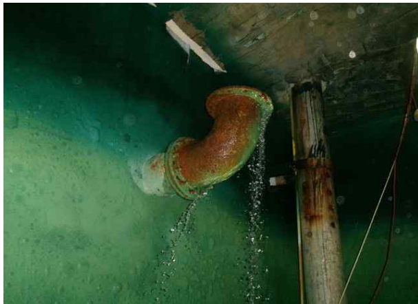
손상내용 1지 유입배관 부식 손상원인 공용열화
