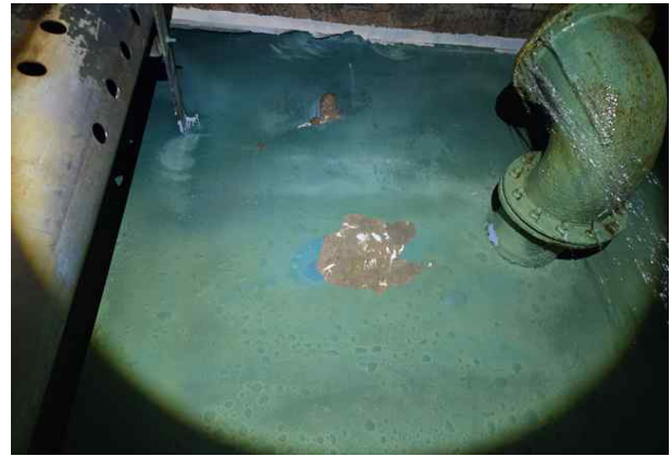
손상내용 2지 벽체 도장박리 손상원인 공용중 열화
