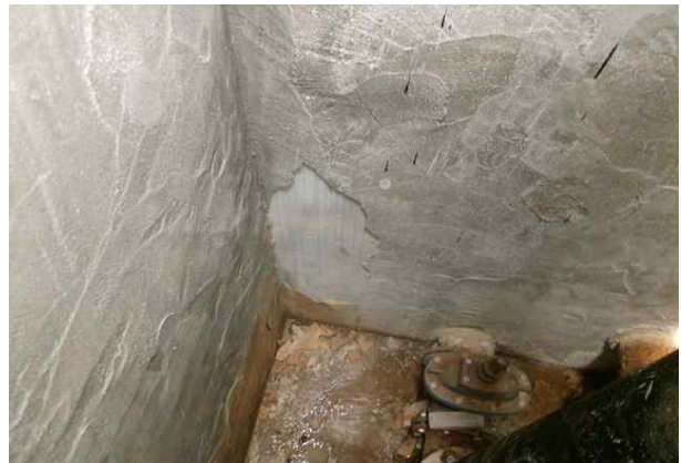
손상내용 유출밸브실(2지) 벽체 몰탈박락 손상원인 장기공용, 시공미흡
