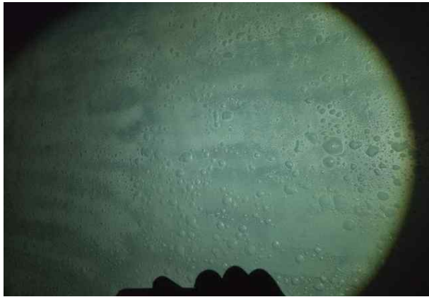
손상내용 2지 벽체 도장기포 손상원인 도장미흡
