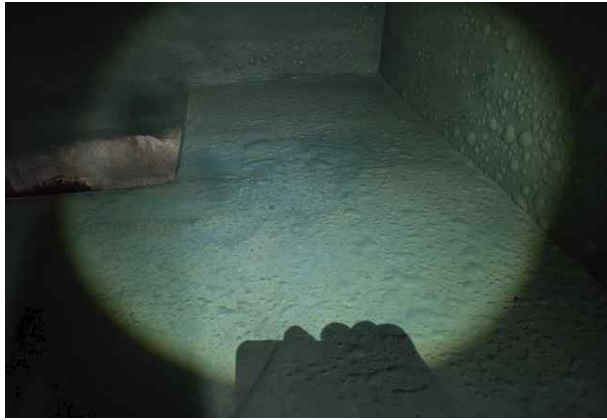
손상내용 2지 바닥슬래브 도장기포 손상원인 도장미흡
