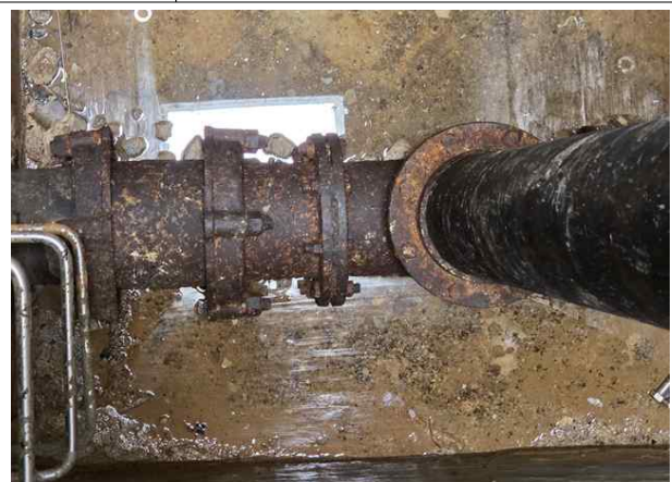
손상내용 유출밸브실(1지) 배관부식 손상원인 공용열화
