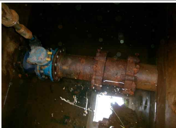
손상내용 유입밸브실(2지) 배관부식 손상원인 공용열화
