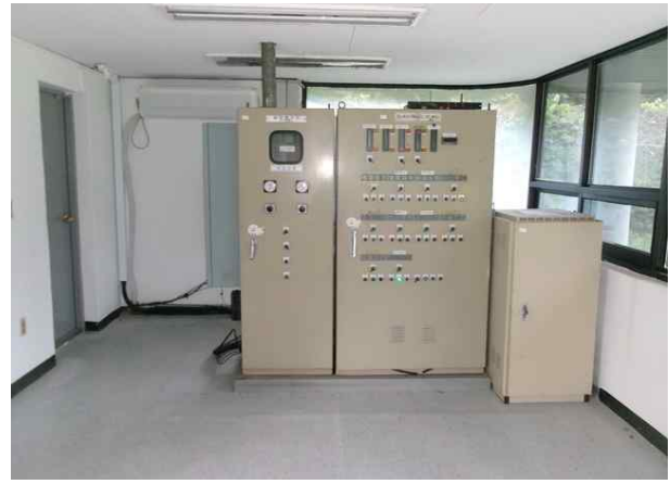
손상내용 현장제어반 상태양호 손상원인 -
