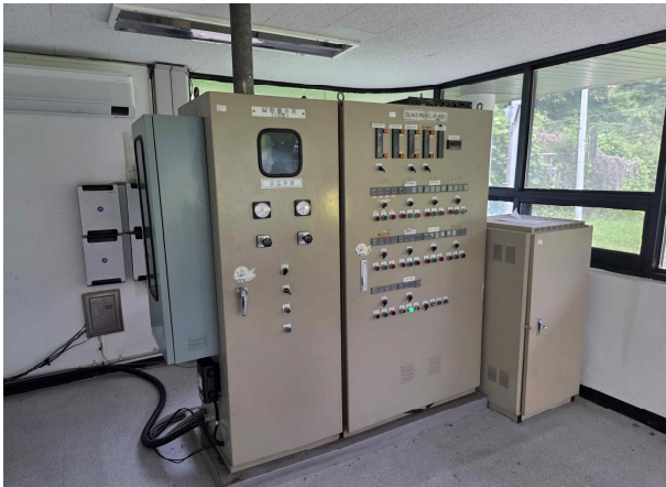
손상내용 현장제어반 상태양호 손상원인 -
