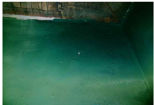
손상내용 2지 벽체 백태 손상원인 공용중 열화, 습윤접촉
