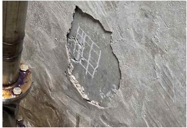
손상내용 유출밸브실(1지) 벽체 몰탈박락 손상원인 장기공용, 시공미흡
