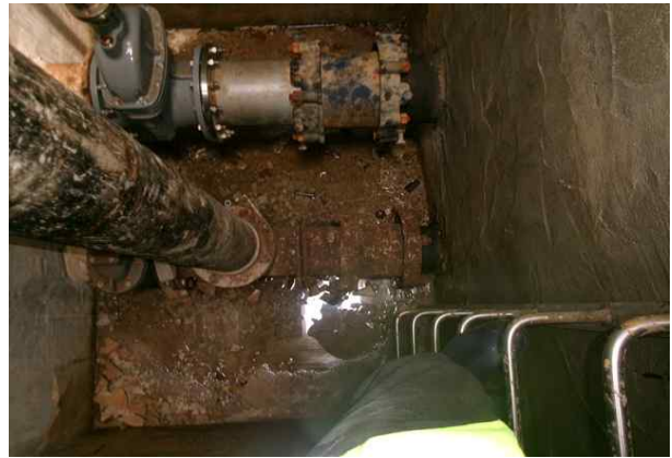
손상내용 유출밸브실(2지) 배관부식 손상원인 외부 우수유입, 습윤침투
