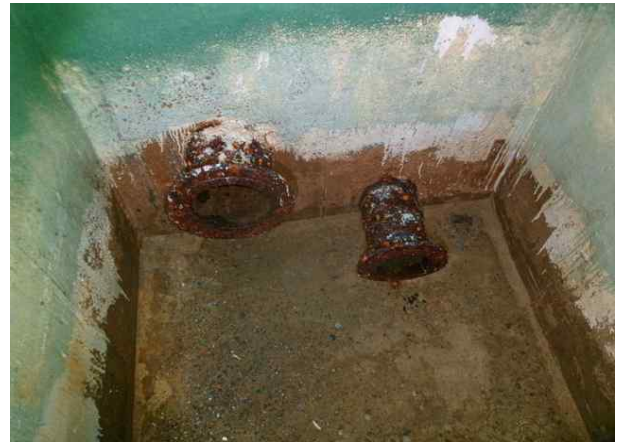
손상내용 2지 유출배관 부식 손상원인 공용열화
