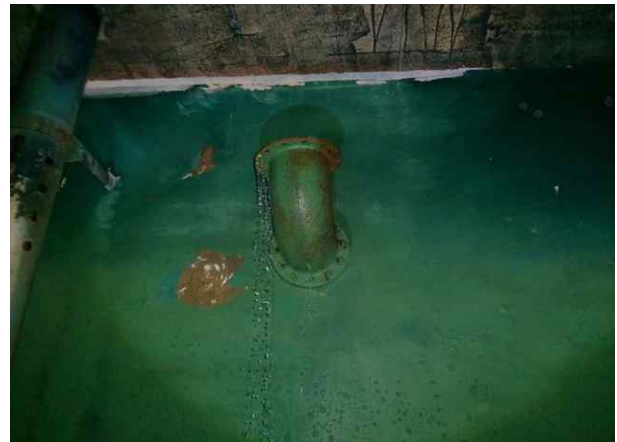
손상내용 2지 유입배관 부식 손상원인 공용열화
