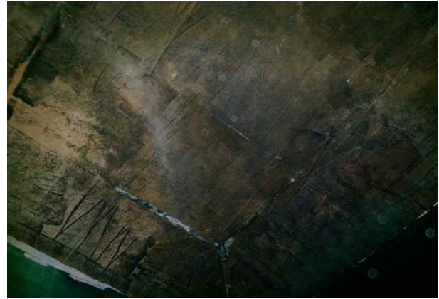
손상내용 2지 상부슬래브 균열 손상원인 건조수축, 공용중 열화
