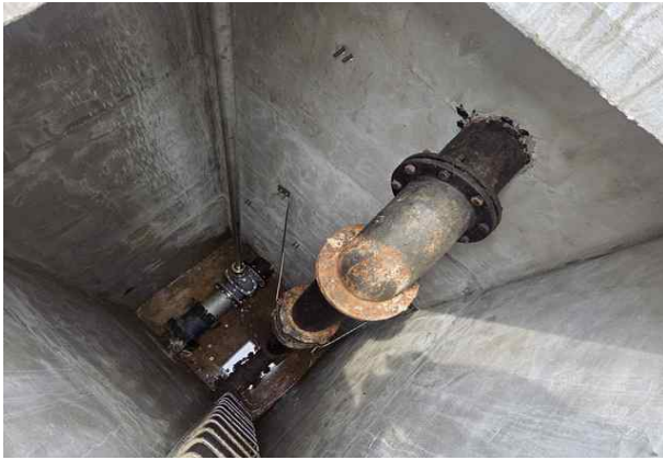
손상내용 유출밸브실(1지) 배관부식 손상원인 외부 우수유입, 습윤침투
