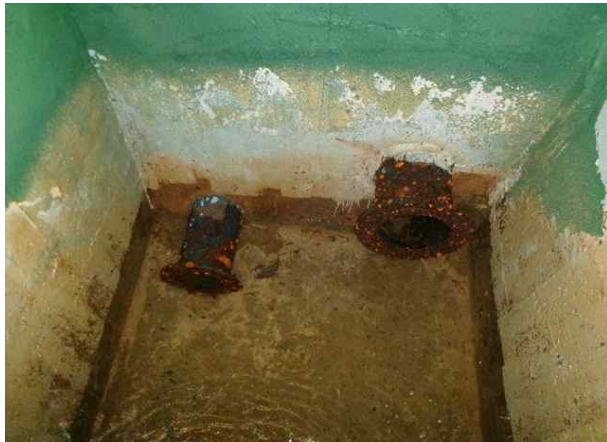
손상내용 1지 유출배관 부식 손상원인 공용열화
