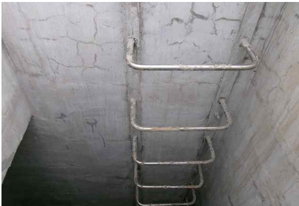
손상내용 유출밸브실(2지) 벽체 망상균열 손상원인 건조수축, 장기공용
